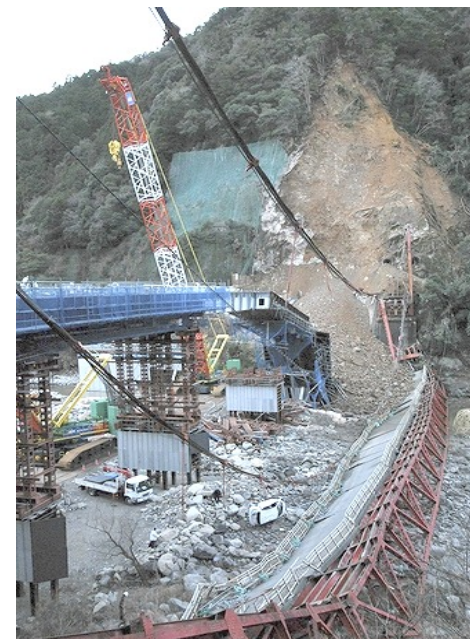
2015.1.31 浜松市原田橋 崩落 2名死亡
